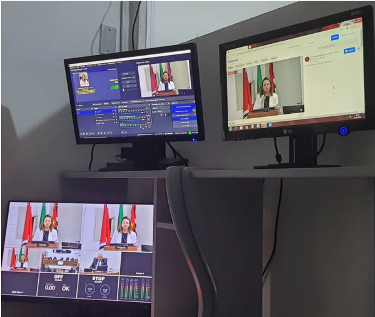
Central de transmissão da Câmara de Santa Isabel
